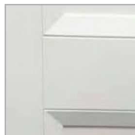
faza na łączeniu ramiaków
